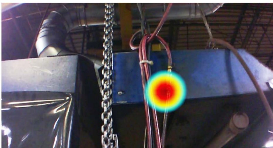
Bilde av en luftlekkasje i industriomgivelser, tatt med ii900 sonisk lekkasjekamera
